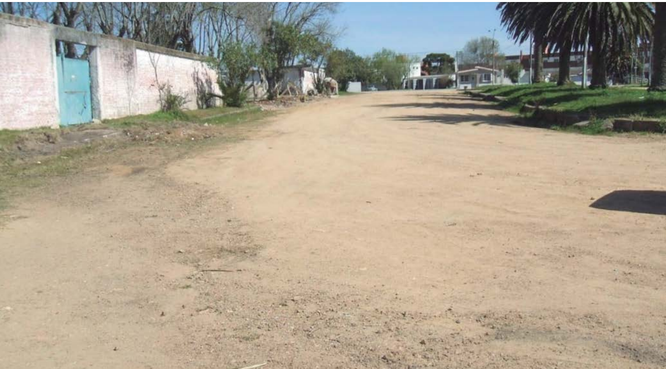
Pavimentos en mal estado y falta de elementos de conducción de aguas pluviales.
